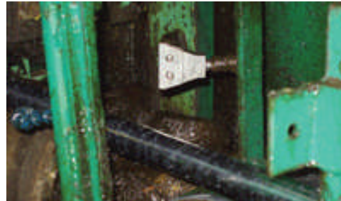
Eine 2" Super Air Nozzle wurde an diese Maschine zusätzlich angebracht, um die Reinigung des Stabstahls zu verbessern.
